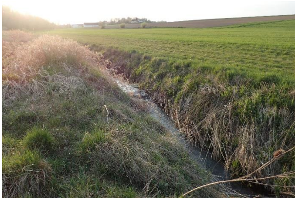
17.04.2020: Blick auf den stark eingetieften Herzogbach in Richtung Westen. Es ist deutlich sichtbar, dass entlang des südlichen Ufers über die Jahre hinweg aus dem Material der Grabenräumungen ein Wall aufgebaut wurde.
